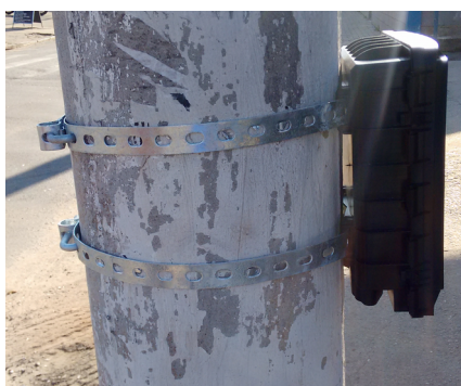
Foto da CTO aplicada em Poste com ferragem externa (BAP)
